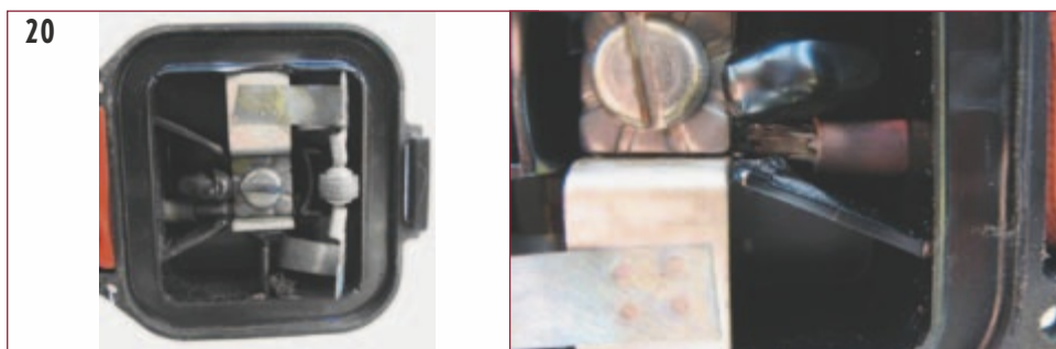
Bild 20 Grund für Temperaturerhöhung: Links: Lockere Schraube der Klemme. Rechts: Litzen des Anschlusskabels teilweise abgebrochen.
