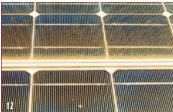
Bild 12 Detailansicht der Verschmutzung des PV-Generators der BFH in Burgdorf nach einer längeren Trockenperiode kurz vor der Reinigung.
